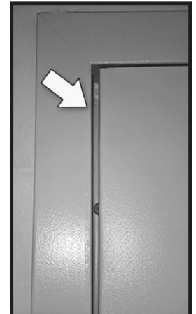
Fig. 13 Excessive Gap at Latch Edge
